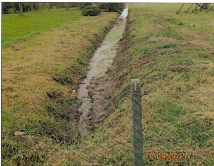
Imagem 26 - Estrangulamento de Canal de drenagem na Empresa Portobello
