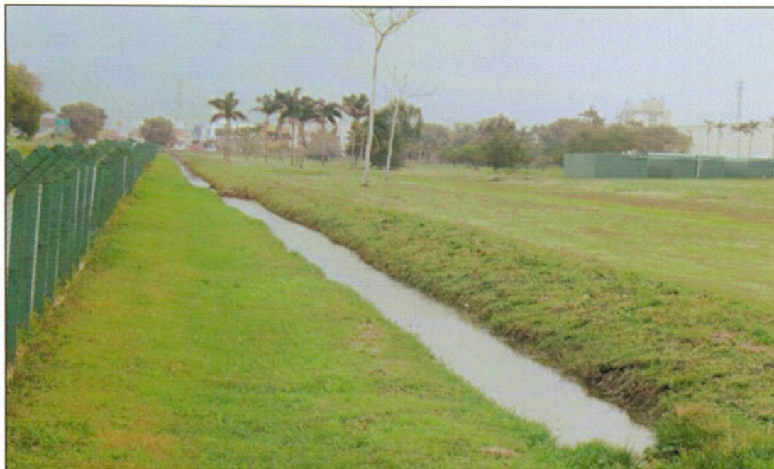
Imagem 28 - Vala de drenagem em frente à empresa Portobello, bairro Areias
