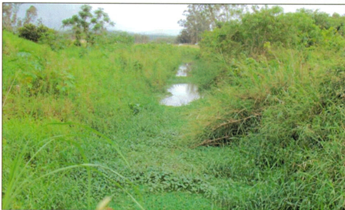
Imagem 27 - Vala de drenagem obstruída por vegetação, bairro Joaia
